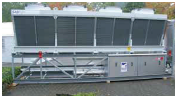
Chiller met propaan als koudemiddel.
