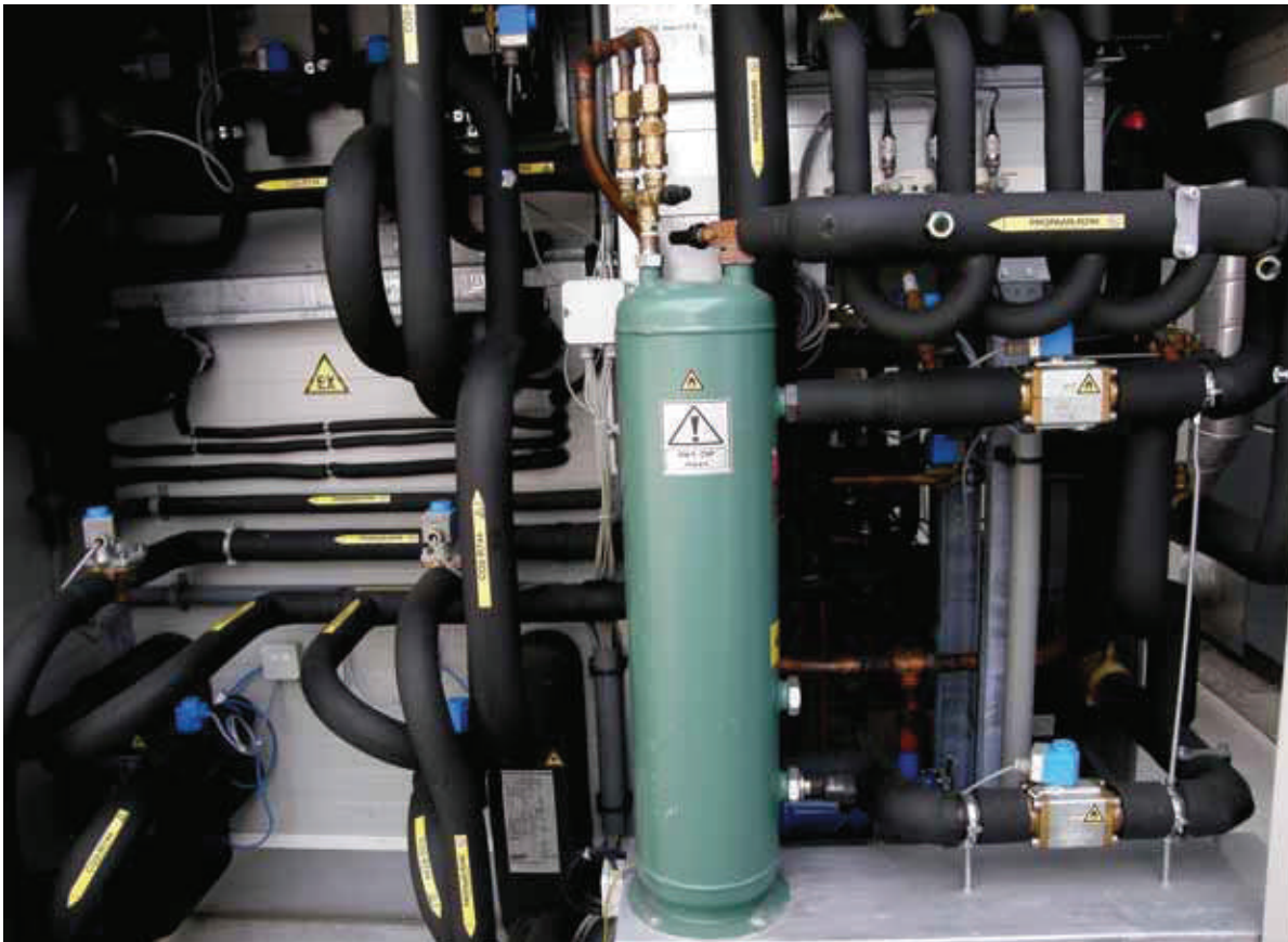
Interieur van een propaan/kooldioxide-koelinstallatie.
