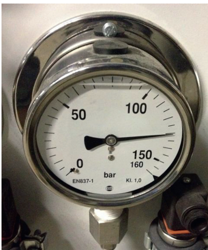
CO 2 -installatie onder hoge druk.
