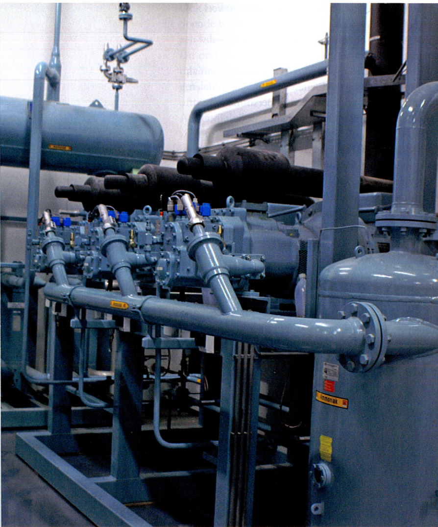
Koelinstallatie met het natuurlijke koudemiddel ammoniak
