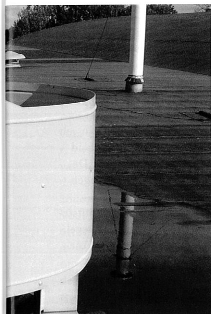
Explosieveilige afzuigventilator op het dak van de machinekamer.
